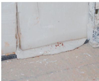
Figura 33. Foto Rebabas incorrecto
